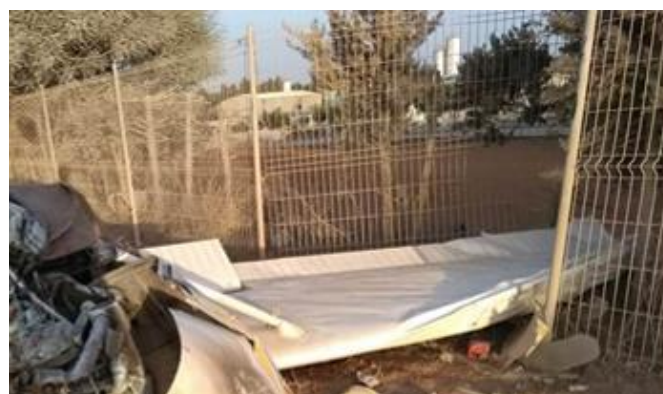
Dommage de la clôture métallique de l'usine PREFAB
